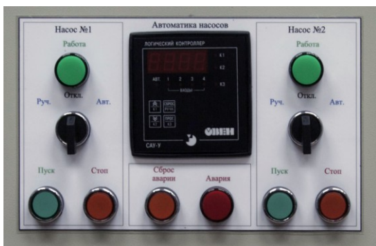
панель станции СУ-12-А исп.1
