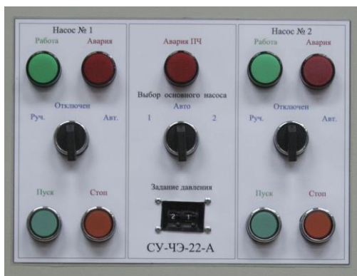
панель станции СУ-ЧЭ-22-А
